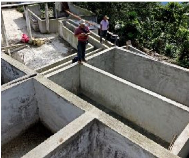
Die neue Anlage zum Wasserrecycling und die Ruhebecken in der Kooperative El Milagro
