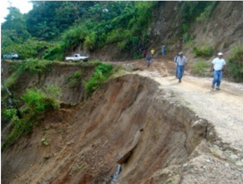
Durchfahrt lebensgefährlich - Erosionsschäden bei Carí
