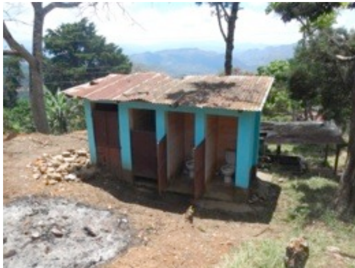
Renovierungsbedürftig: Die Toiletten für die Kinder von Taguayni
